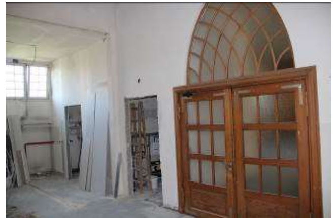
Bild: Neue Ansicht vom Foyer; die Toilettenverschläge links der Haupttür sind bereits abgeräumt und neue Türeingänge wurden geschaffen.
